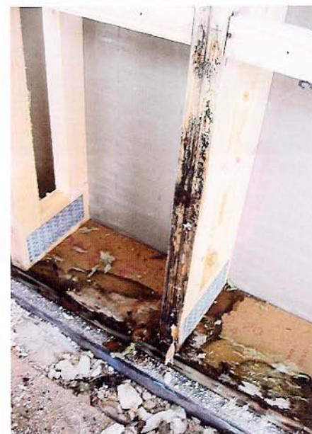
Bild 2: Mikrobiell påväxt orsakad av höga fuktillstånd i oventilerad vägg med putsad cellplastisolering.
