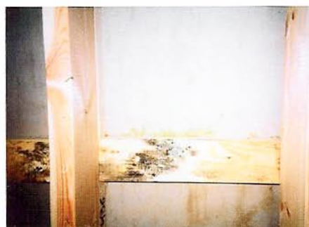
Bild 1: Mikrobiell påväxt på regelverk orsakad av högt fuktillstånd i väggen till följd av fukt som läckte in under bygget.
