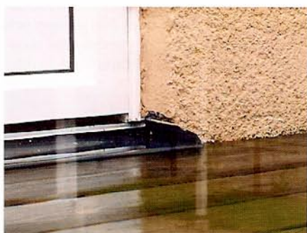
Bild 7: Otät i anslutning till altandörr.
